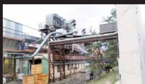
Na místě zasahovali hasiči z několika jednotek. Práce bylo dost... Foto: HZS Olomouckého kraje
