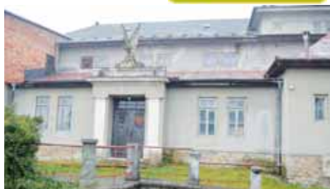
Zatímco v řadě obcí je sokolovna centrem sportovního a společenského dění, v Konici dlouhodobě chátrající stavba spíše hrozí zřícením... Foto: archiv Večerníku
